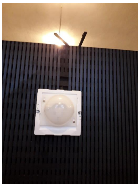
Zwei ausgebrochene Lamellen Foto Dagmar Hesse
