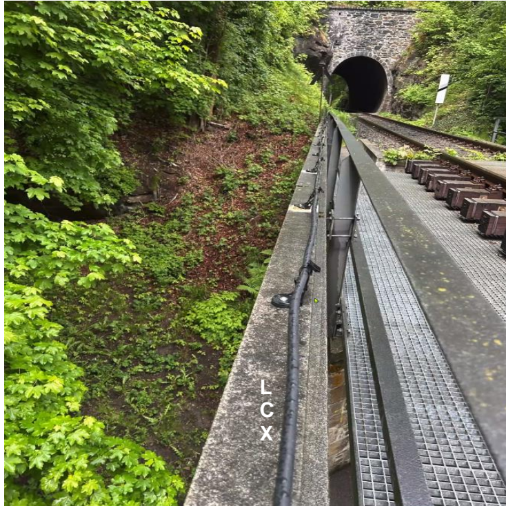
Abbildung 6. LCX-Kabel entlang des Bahngleises.
