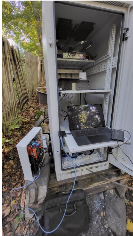
Abbildung 2. 5G-Core und gNB in einem Technischrank im Wald.
