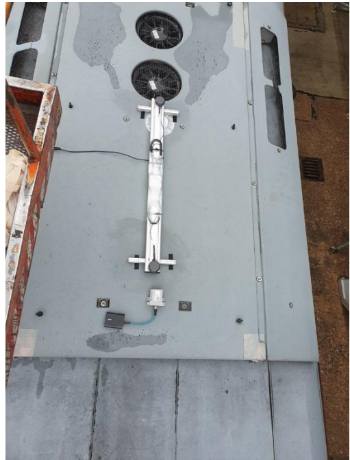
Abbildung 7: temporärer Versuchsaufbau auf dem Dach eines Desiro VT 642 der Erzgebirgsbahn mit dem prototypischen GNSS-System
