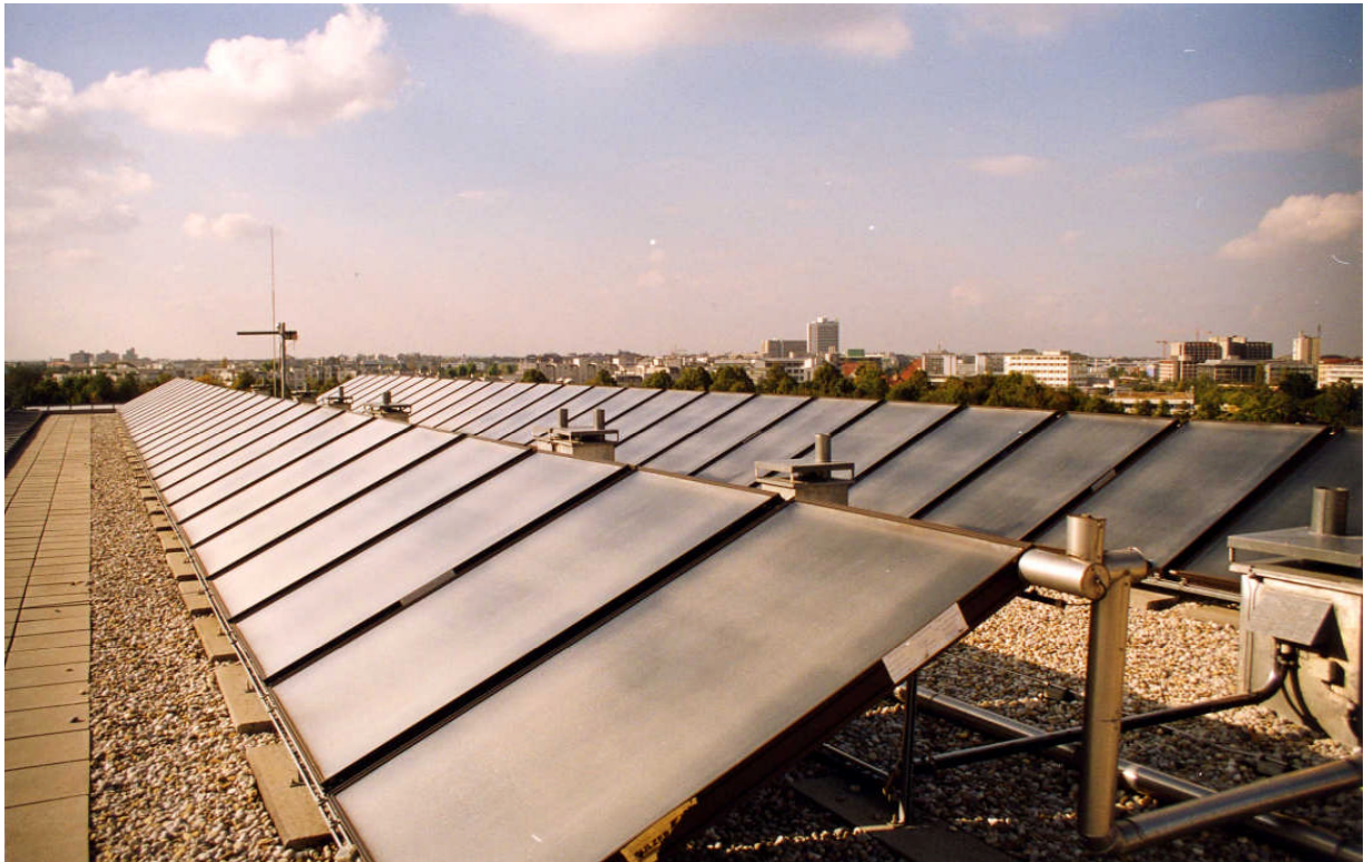
Abb. 10.3: Teilansicht des Kollektorfeldes auf dem Wohngebäude München-Baumgartnerstr.
