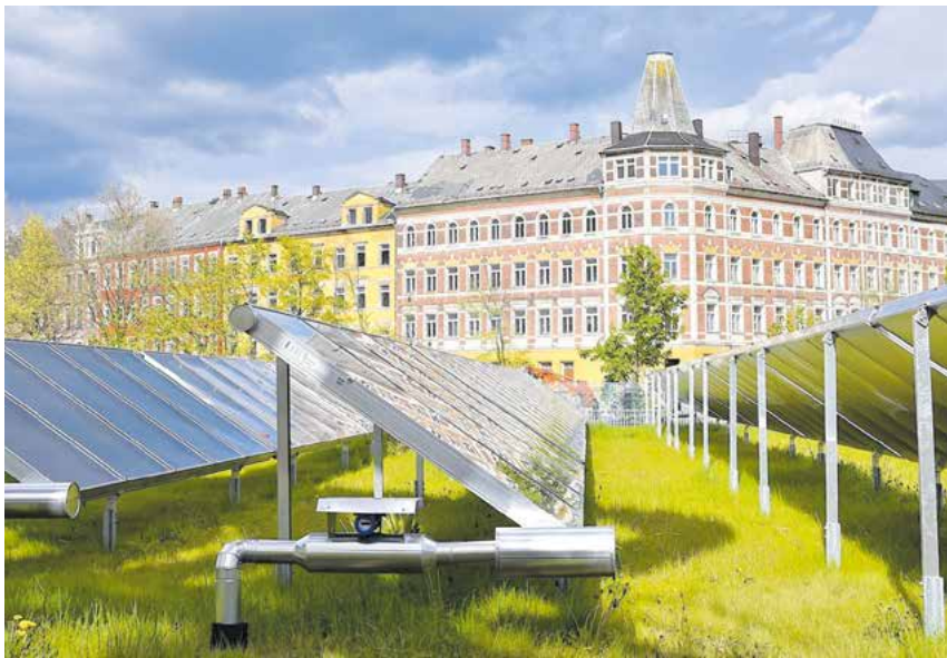
Rund 230 Häuser am Chemnitzer Brühl werden bereits mit Sonnenwärme versorgt. Der Bau der Anlagen durch die eins energie (inetz) wurde mit 2,3 Millionen Euro Städtebaufördermitteln unterstützt. Archivfoto: Thorsten Urbaneck/TU Chemnitz
