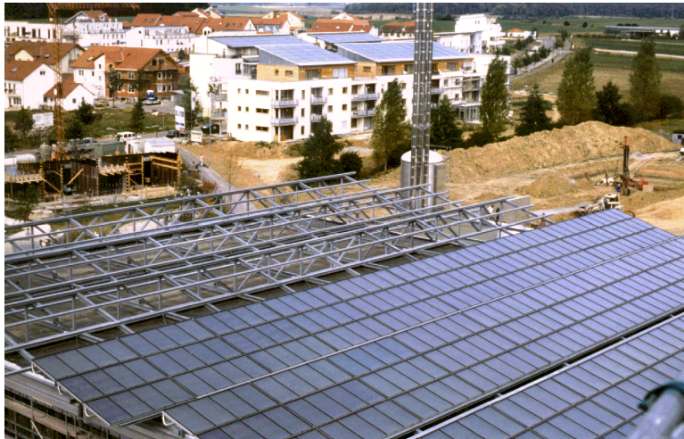
Bild 9: Kollektoren auf der Sporthalle in Neckarsulm-Amorbach
