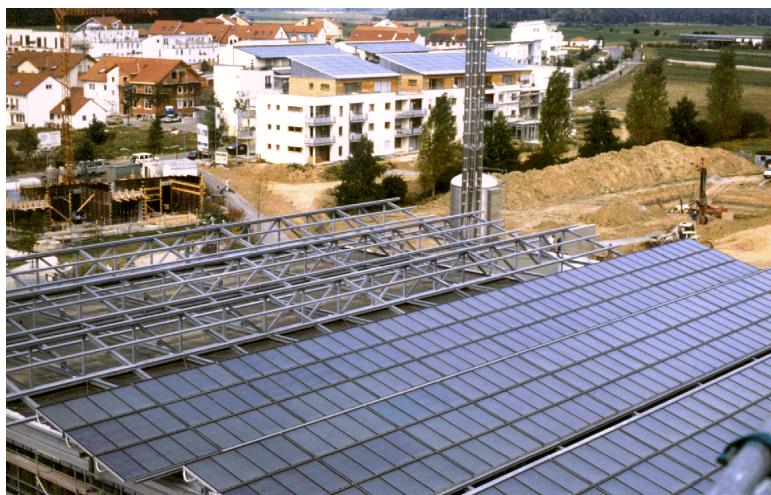
Bild 9: Kollektoren auf der Sporthalle in Neckarsulm-Amorbach
