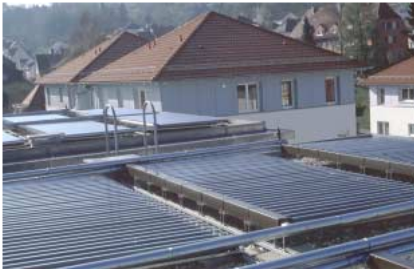
Bild 12: Vakuumröhren-Kollektorfeld in Schwäbisch-Gmünd
