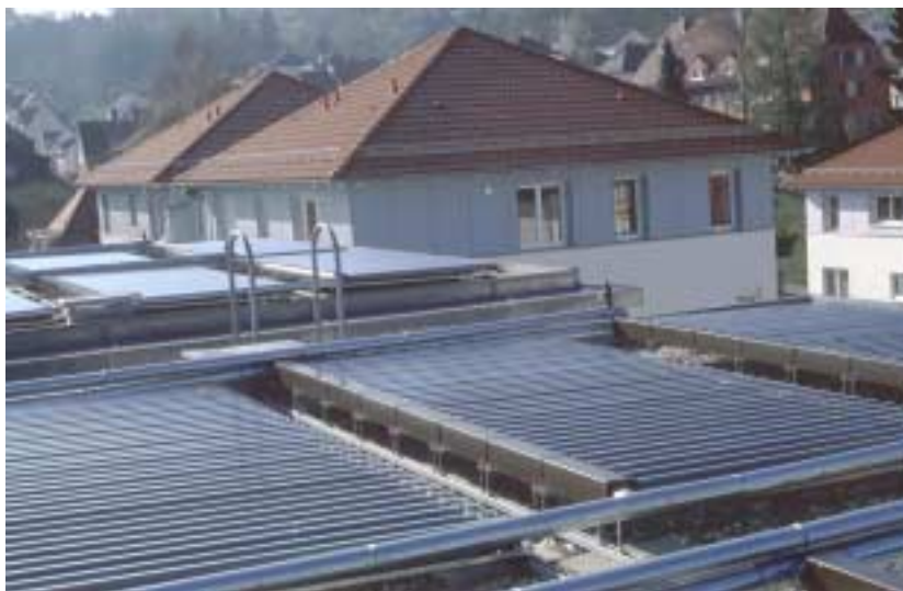
Bild 12: Vakuumröhren-Kollektorfeld in Schwäbisch-Gmünd
